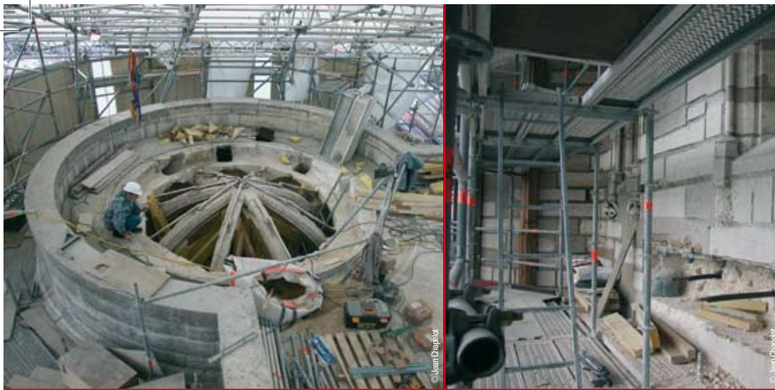
Mise au jour lors de la restauration au début de 2004 Dégagement du cerclage métallique médiéval dans des tirants métalliques médiévaux renforçant les arcs le parement extérieur du donjon au niveau du sol du couvrant la tourelle sud-ouest de la terrasse du donjon. troisième étage.
