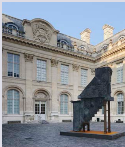
La façade de l'hôtel de Saint-Aignan garde encore les traces des étages rajoutés pour diviser le bâtiment en logements (Paris, 3 ème ).
